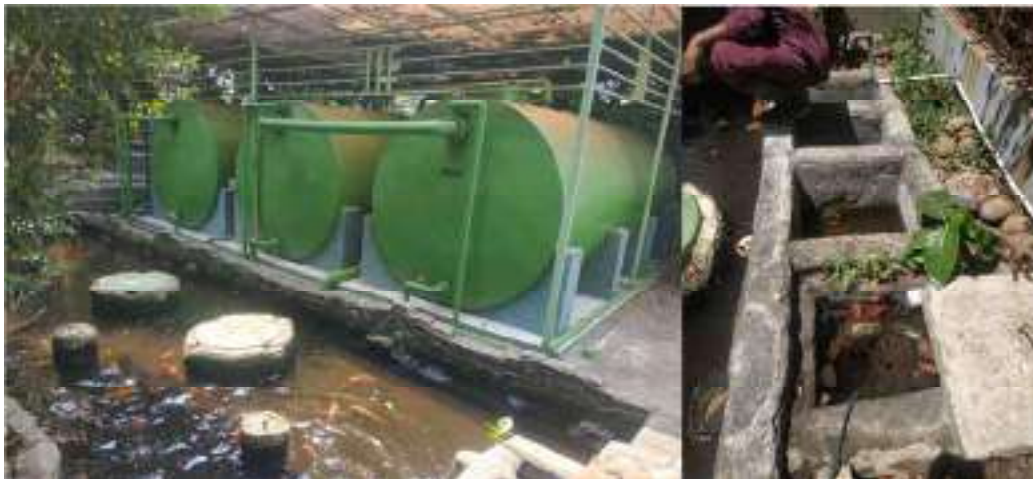
Gambar 2.19 Instalasi Pengolahan Air Limbah RSUD Bendan
